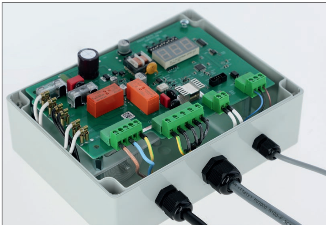
Figura 9: Circuito impreso en la carcasa de la unidad de control (condensador detrás del circuito impreso)
